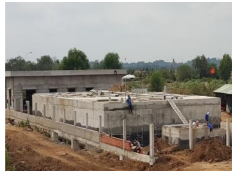
Trạm XLNT khu ĐTDL Đại Phước
