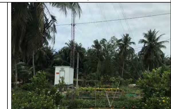
Trạm điện hiện hữu
