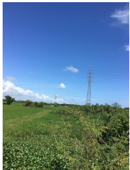
Trụ điện 110kV
