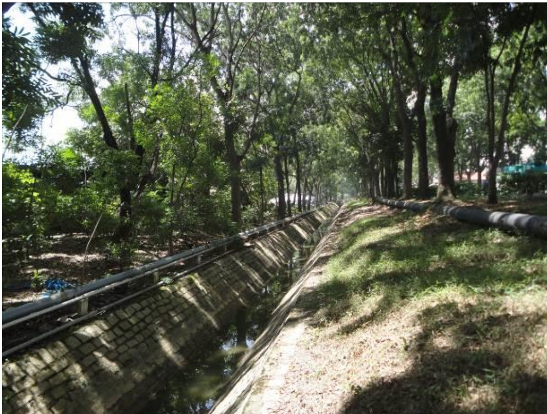
Hình 14: Mương thoát nước chạy dọc đường số 1.
