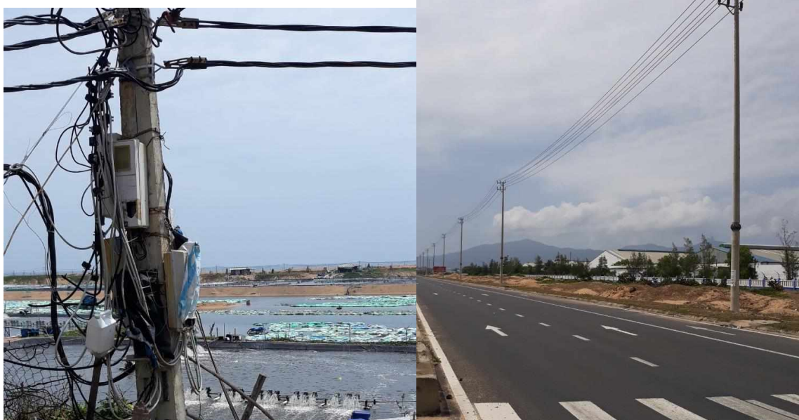
Hiện trạng lưới điện tại khu vực
