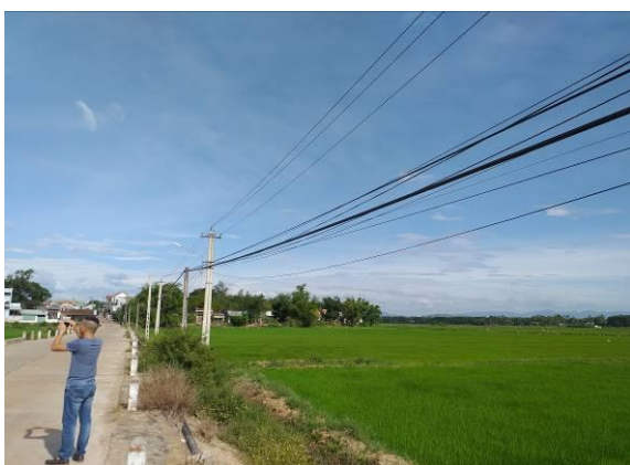
Đường điện tại đường Huyền Trân Công Chúa
