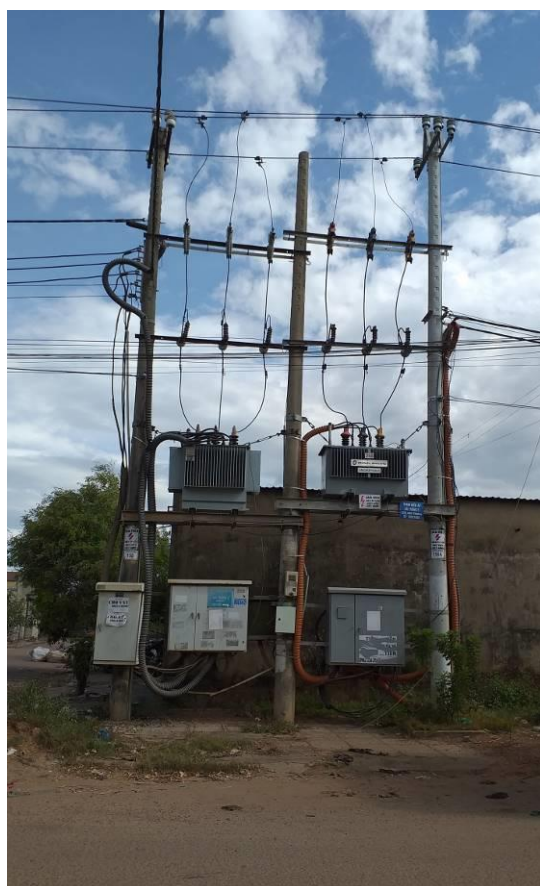
Trạm biến áp tại cụm công nghiệp Gò Đá Trắng
