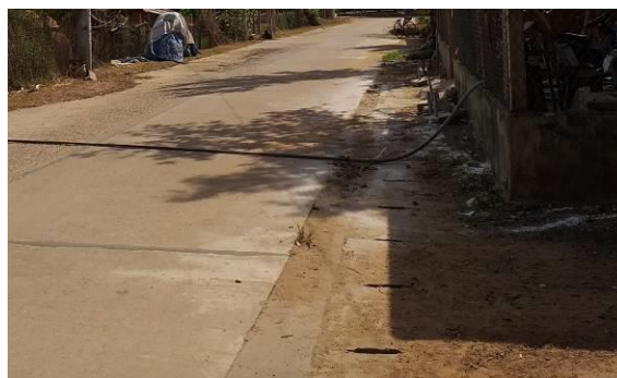
Hệ thống cống rãnh thoát nước xuống cấp, không hoạt động
