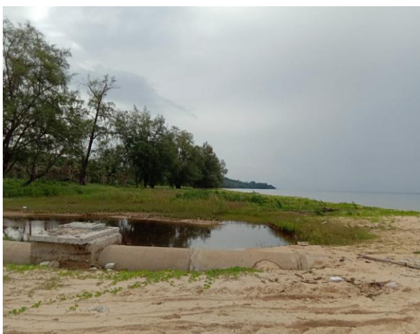
Cống thoát nước KCN Hòa Hiệp
