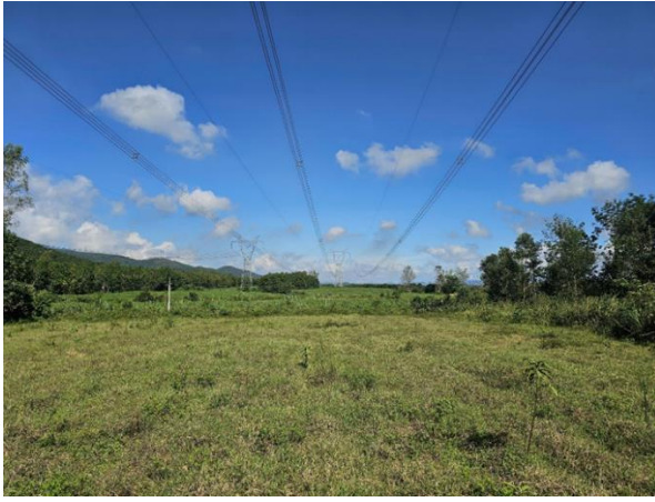
Đường dây 500Kv
