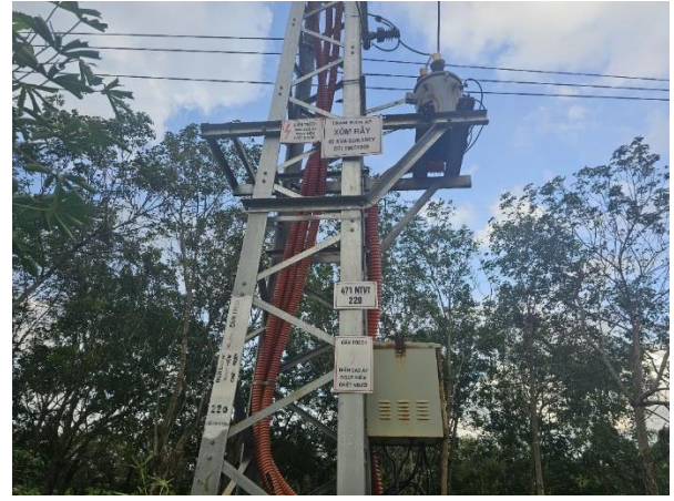
Trạm biến áp Xóm Rầy
