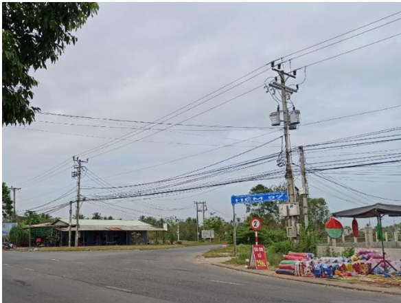
Đường điện trung thế
