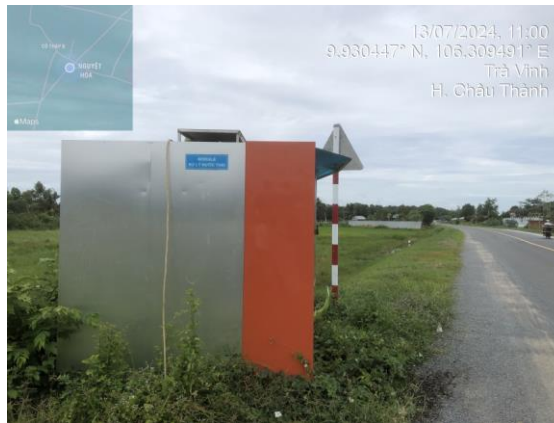
Module xử lý nước thải
