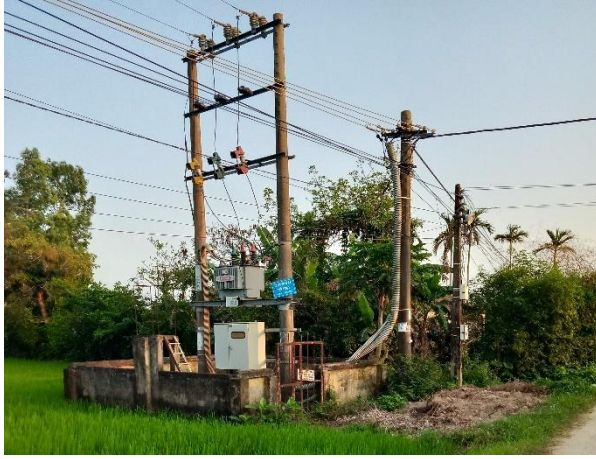
Trạm biến áp cấp điện sinh hoạt
