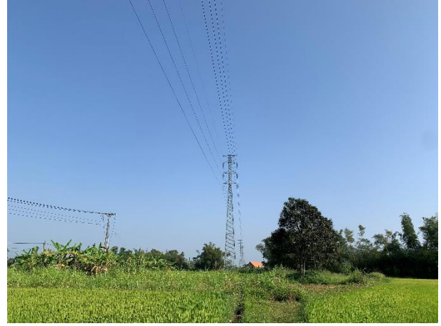
Lưới điện cao thế 110kV
