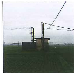
TRẠM BIẾN ÁP THÔN CAO THẮNG 2
